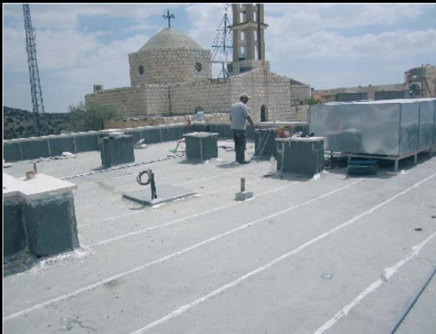
A Al-Hashimi et Al-Rusaïfeh, les presbytères ont subi de grosses réparations (photo ci-dessus et au centre), alors qu'à Al-Wahadneh en a été construit un nouveau. Ici les travaux (ci-dessous) sont encore en cours sur le toit.
