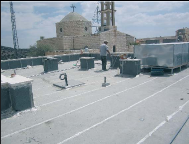
In Al-Haschimi und Al-Rusaifa wurden wichtige Renovierungen an den Pfarrhäusern vorgenommen (Foto oben und Mitte), während in Al-Wahadna ein neues gebaut wurde. Hier ist das Dach noch in Arbeit (unten).
